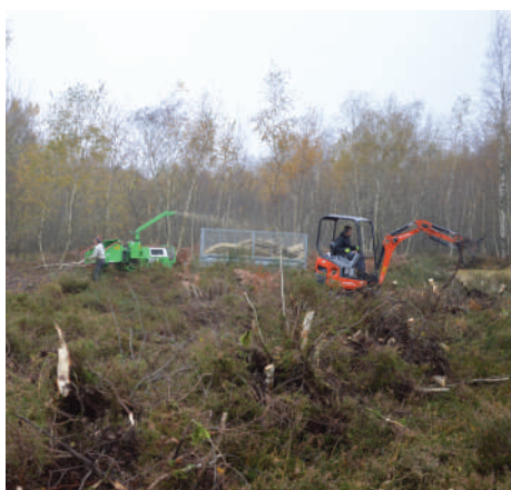
Travaux d'arrachage mécanique : pour une régulation optimale de l'eau par la zone humide, il faut maîtriser le développement des arbres. Ils consomment beaucoup d'eau et d'espace.
