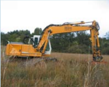
L'intervention d'une entreprise spécialisée est nécessaire pour les travaux : le sol étant très peu portant un tracteur agricole « classique » risquerait de s'embourber.
